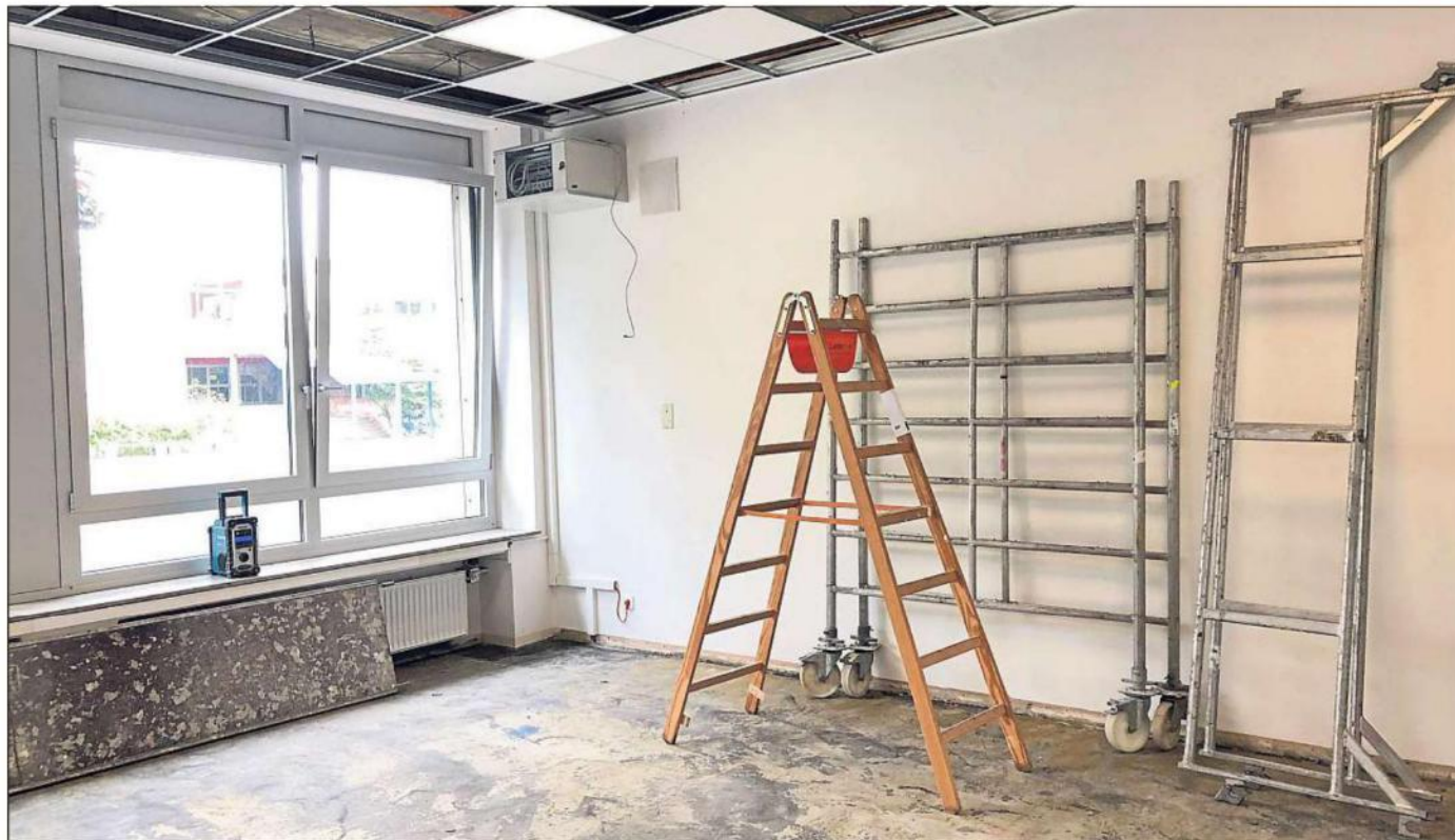
Im Albertus-Magnus-Gymnasium in Beckum sind die Handwerker aktiv. In den Gebäuden eins und zwei werden komplette Klassen renoviert. Dabei entsteht unter anderem mehr Platz für Inklusion. Foto: Biefang
